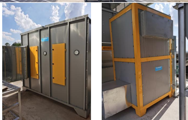
活性炭吸附濃縮及催化燃燒組合設備
